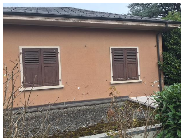
Façade extérieure à rénover
